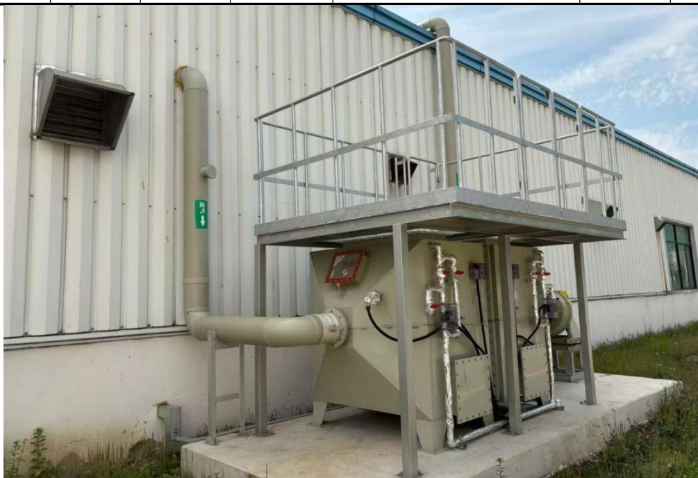
图 4.1-2 废气处理设施
