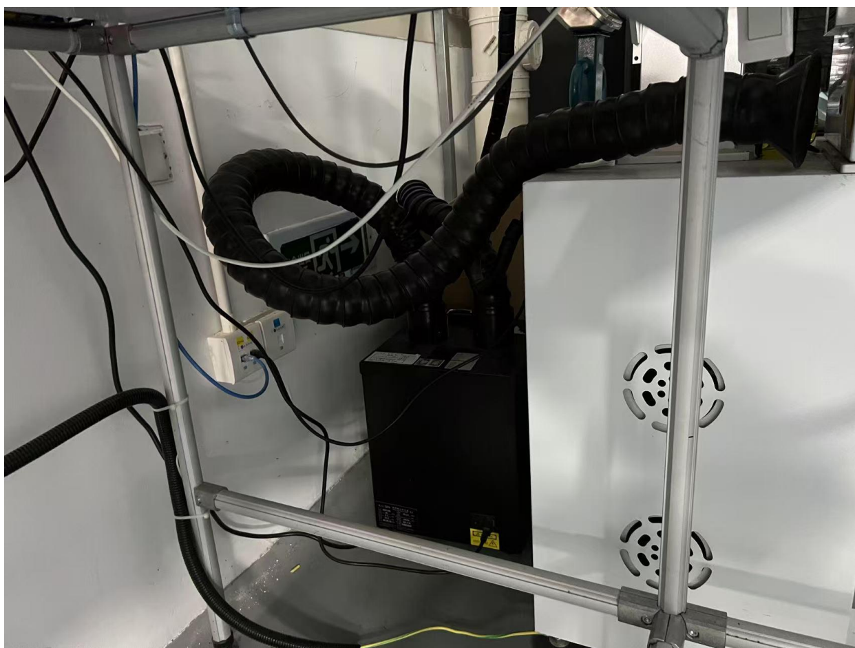
图 3.2-1 干式滤网除尘器现场图片
